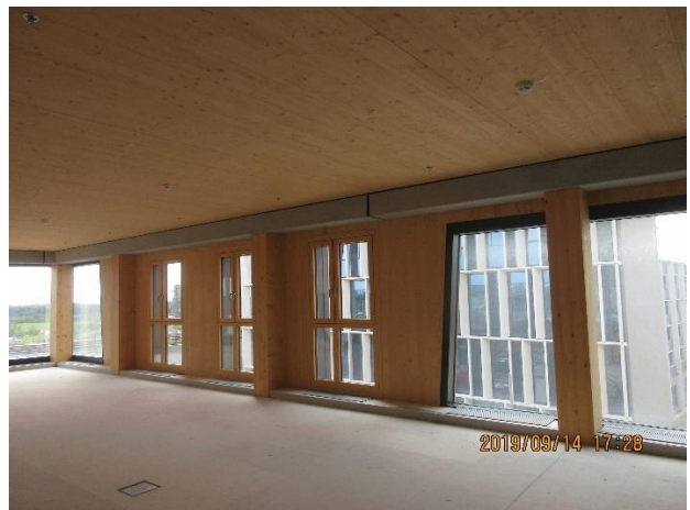
HOHO NEXT 内部（構造は HOHO ウィーンと同じ）
